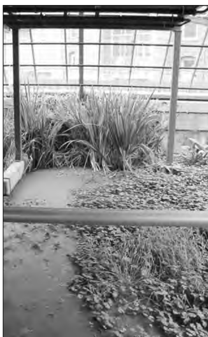
Bassin de traitement biologique des eaux usées.
